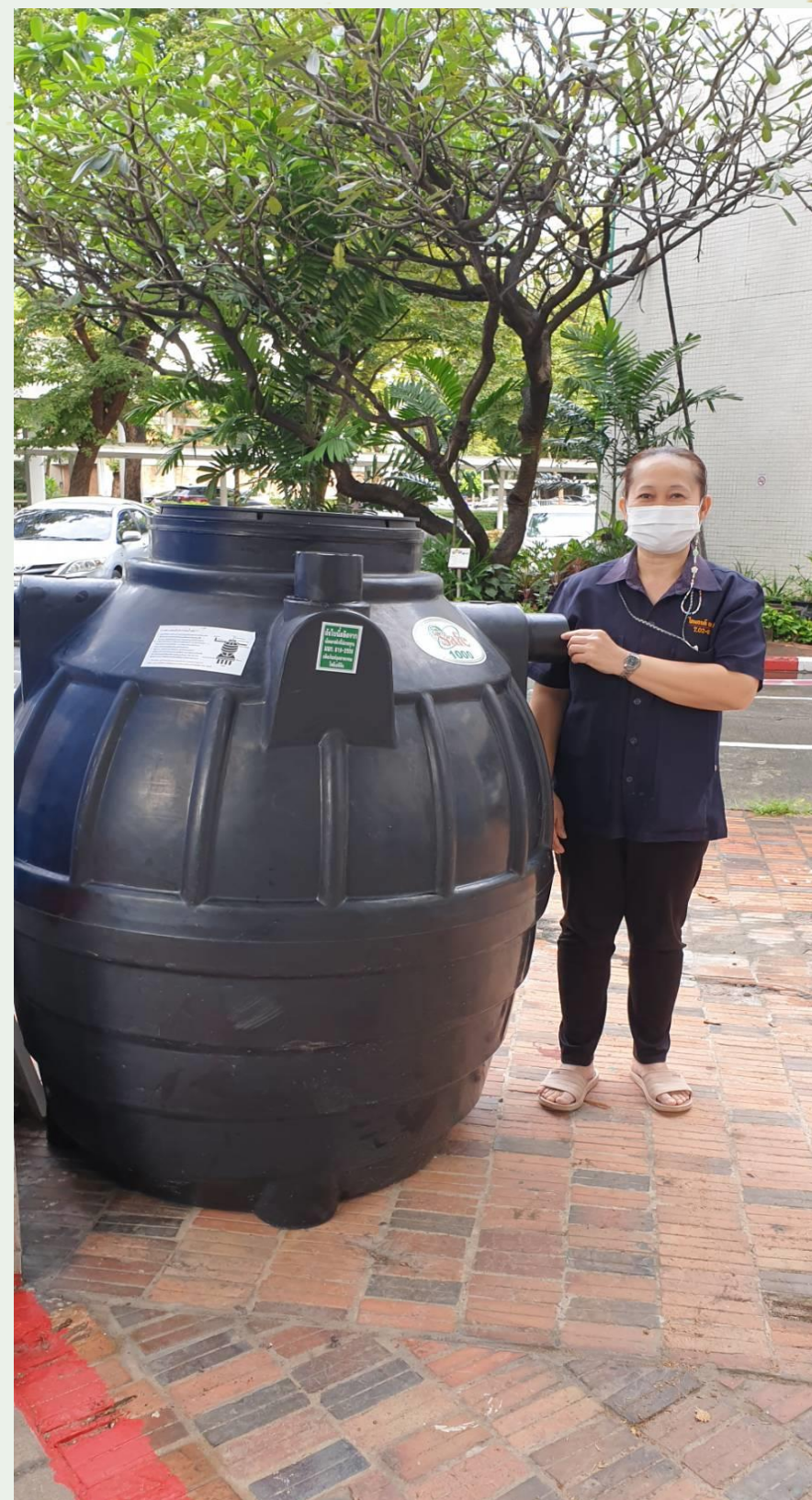
ถังบำบัดน้ำเสียจากห้องอาหาร
