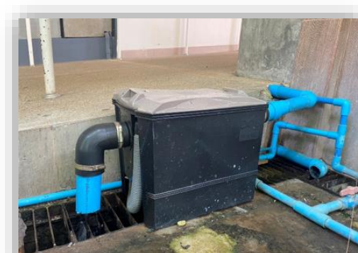
ถังดักไขมันร้านสดชื่น
